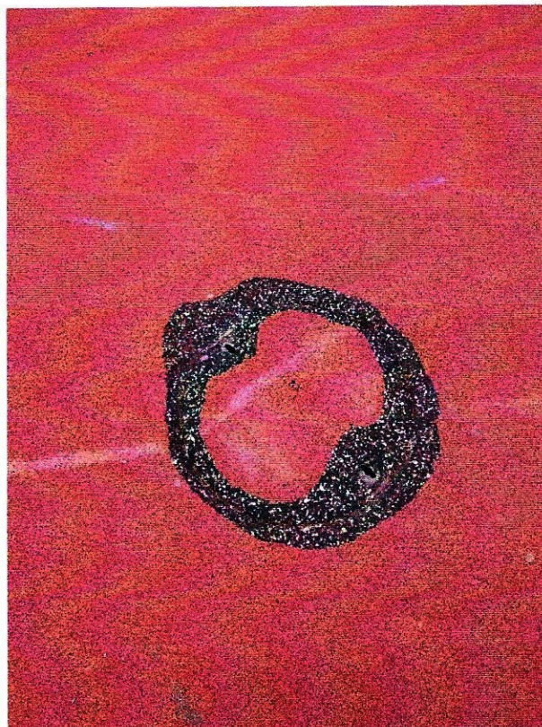
Fot. 4. Widok ubytku w podłożu boiska (2)
